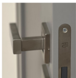
WIDOCZNY BRAK FELCA
